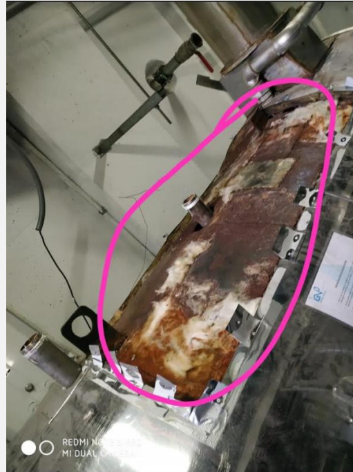
Corrosión parte superior y parte interna de caldera
